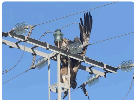
Rapaz electrocutada en cruceta con aisladores sin forro.
