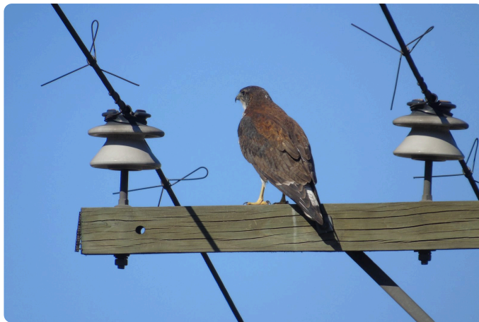
Electrocución. Una rapaz posada entre dos aisladores sin protección: basta abrir las alas para cerrar el circuito.
